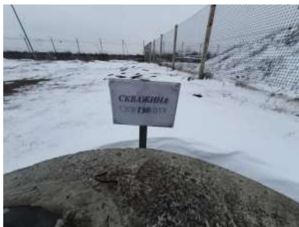
Фото №106 Сооружение (Скважина 1), кадастровый номер: 23:43:0109002:458
