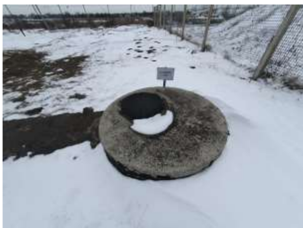
Фото №105 Сооружение (Скважина 1), кадастровый номер: 23:43:0109002:458
